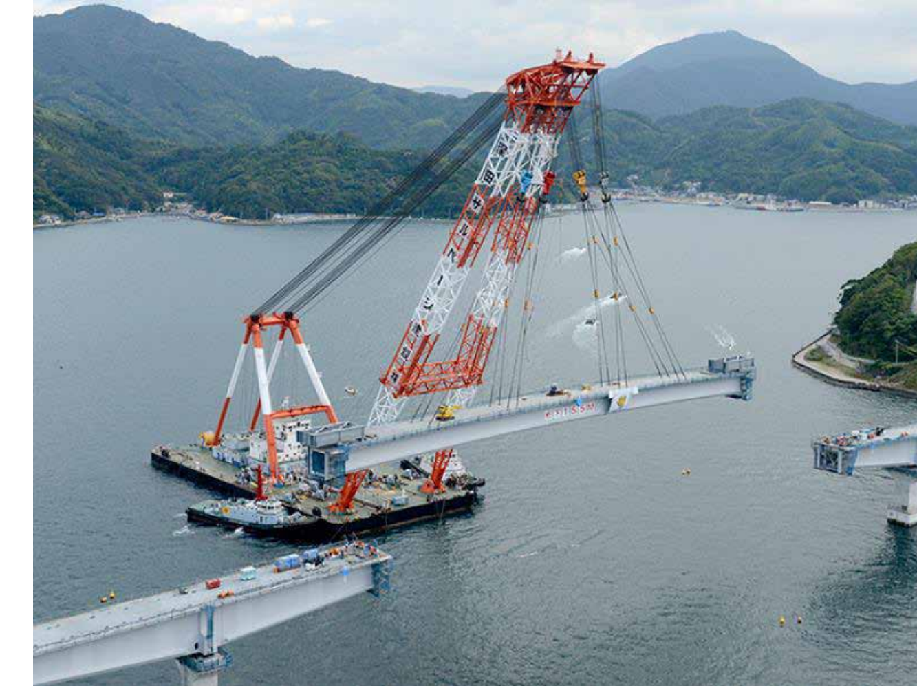
フローティングクレーン架設 海に浮かぶ大型クレーン船を使って、現場で組み立てた大きな橋げたを一気にかける方法
