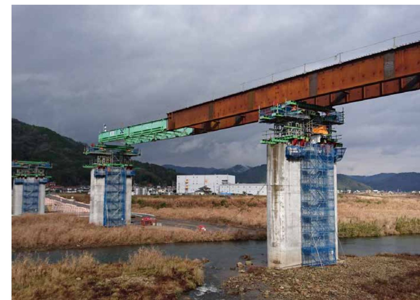
送り出し架設 橋げたの先に取り付けた「手のべ機」を使ってバランスをとりながら、向こう岸まで橋げたを送り出す方法
